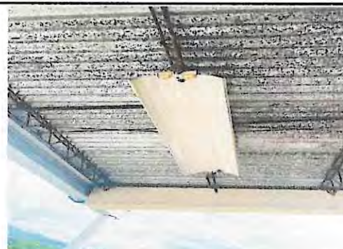
Foto 4: El sistema eléctrico en su totalidad esta dañado, necesita ser sustituido.
