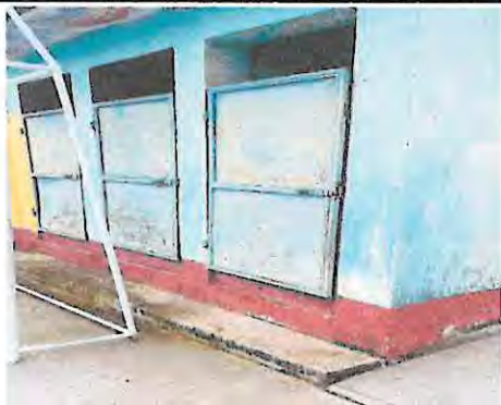
Foto 1: Puerta de los sanitarios en mal estado, deterioradas.
