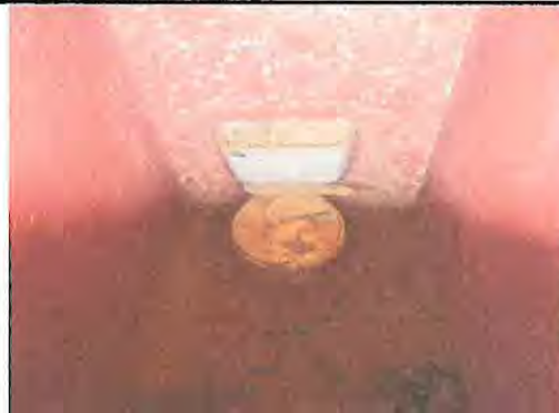
Foto 2: Sanitarios en malas condiciones, están fuera de servicio, necesitan ser sustituidos y cambiar los accesorios para ponerlos en función.
