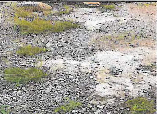
Foto 3: Losa de patio, esta completamente deteriorado e incompleta, debido a la situación del terreno y a la mala calidad de construcción.
